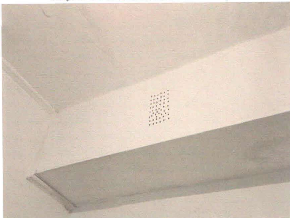
Рисунок 18. Состояние системы вентиляции
