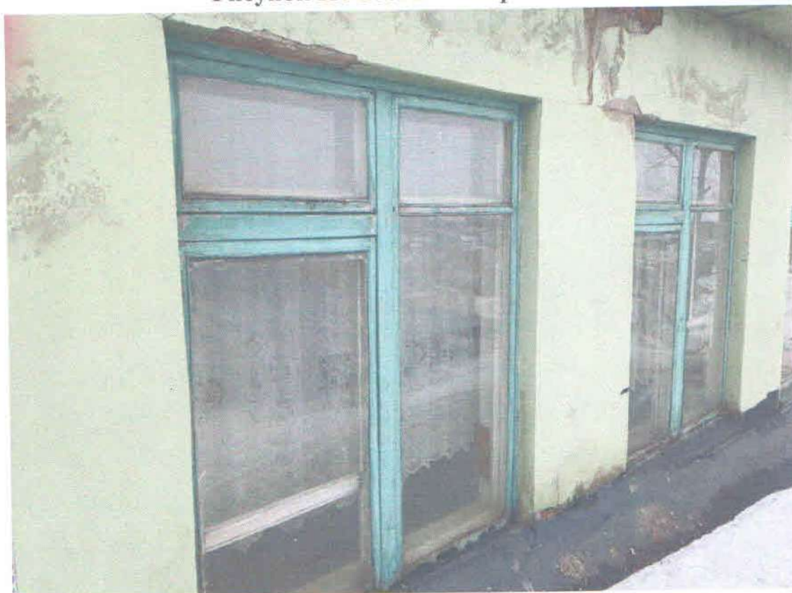
Рисунок 14. Состояние окон и оконных рам
