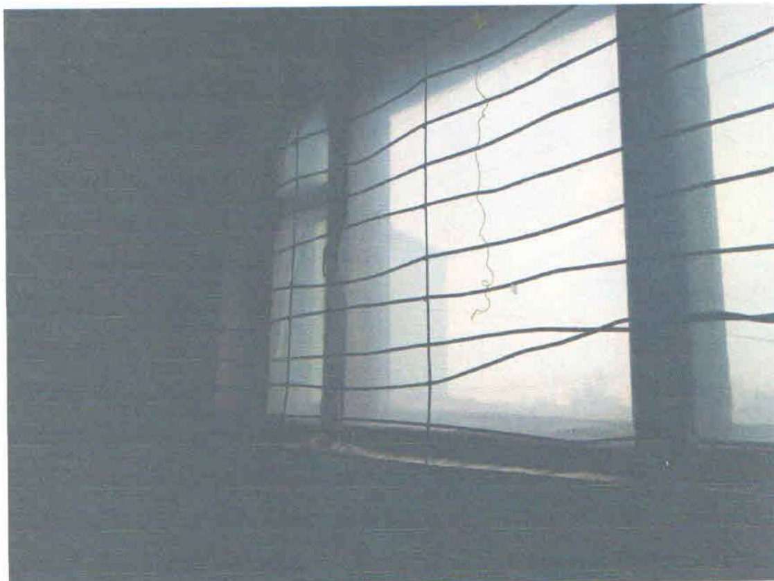
Рисунок 17. Состояние окон и оконных рам
