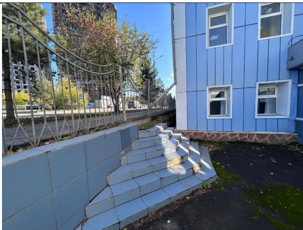
Крыльцо в галерею. Отсутствует пандус
