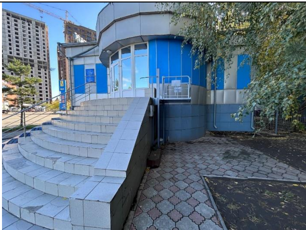
Сколы на ступенях. Подъемник не работает
