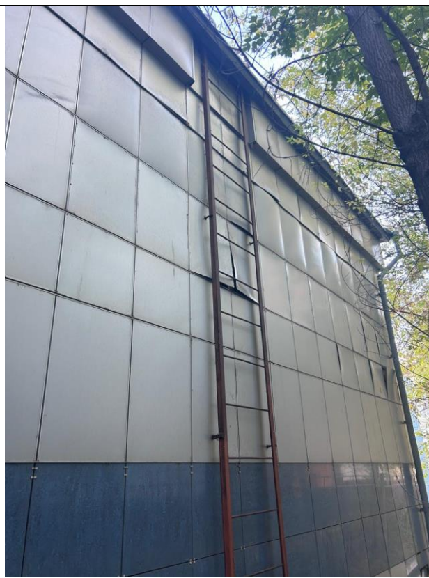
Отсутствует ограждение лестницы Литер А2
