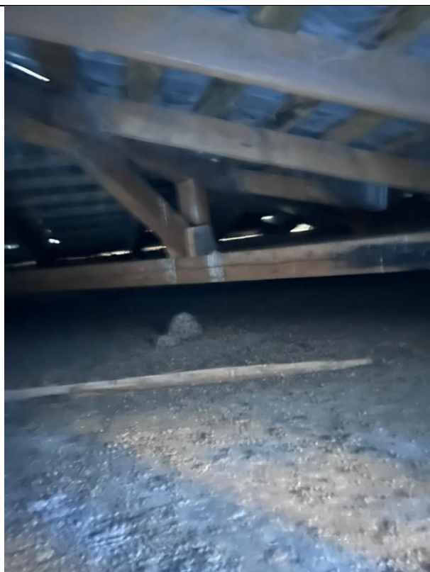
Наблюдаются просветы в покрытии
