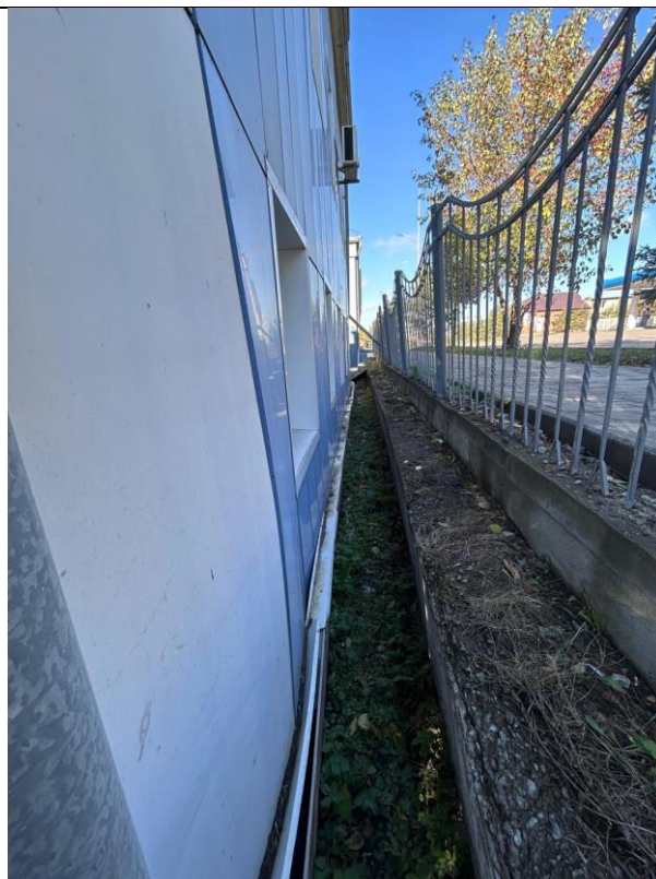
Пазухи необходимо засыпать и выполнить бетонную отмостку с отводом талых вод.
